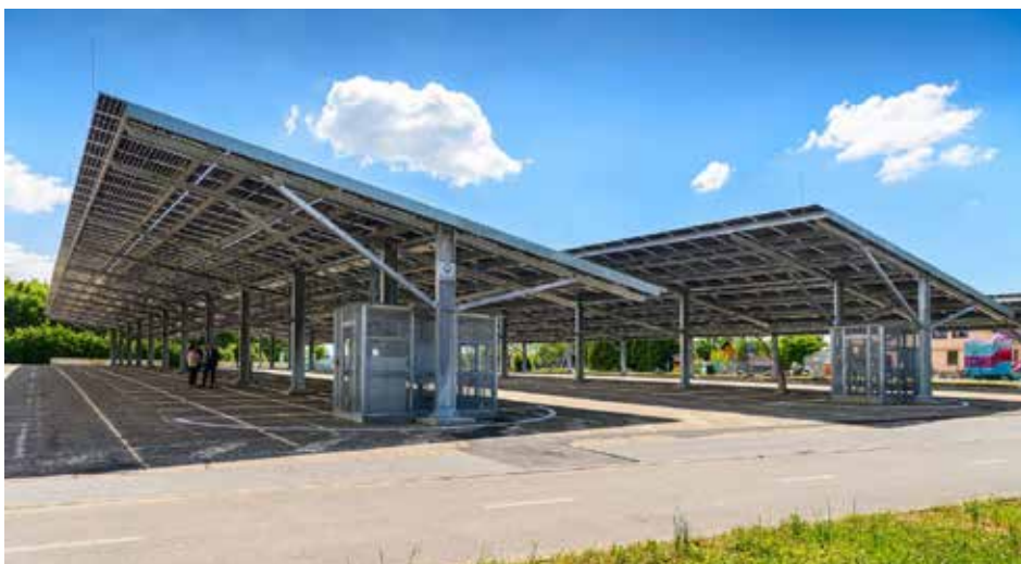
Fotovoltaická elektrárna u ZOO Zlín-Lešná. Jde o druhý největší carport v České republice.
