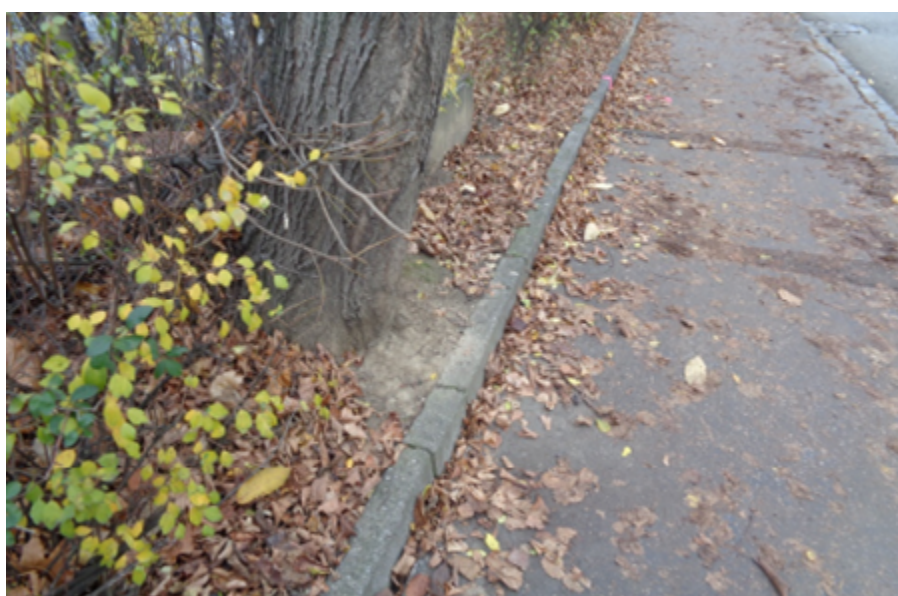
↑ Pata kmene stromu v těsné blízkosti chodníku
