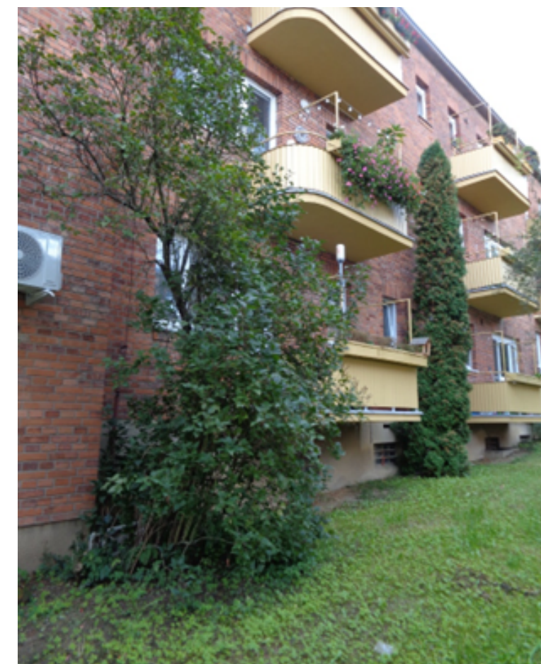
↑ Nevhodné dřeviny v blízkosti fasád
