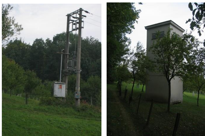
Trafostanice T4 a T5
