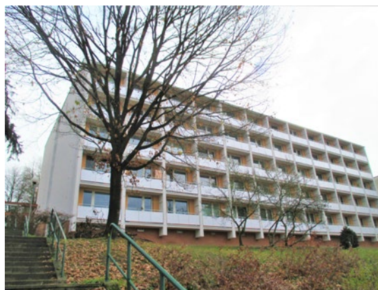
Projekt Zateplení, oprava lodžii, vstupu a schránek BD, ul. Družstevní 4509, Zlín – dotace z Integrovaného regionálního operačního programu (IROP)
