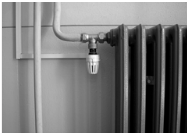
Termopohon systému IRC instalovaný na radiátorech základní školy.
