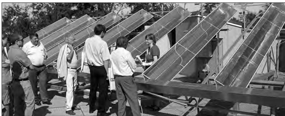
Solární kolektory na bázi lineárních (Fresnelových) čoček, které sledují denní pohyb slunce po obloze.
