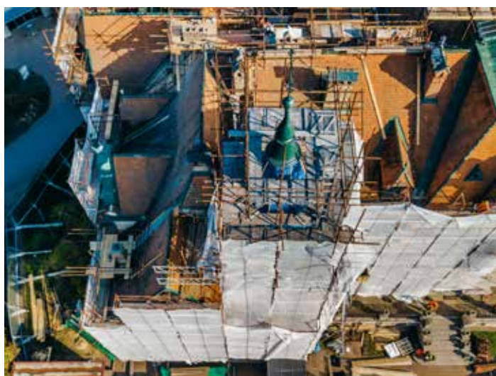
Střecha začínala být v havarijním stavu. / foto: Zoo Zlín
